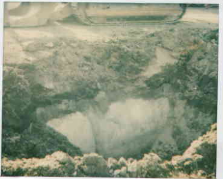
12/21/92 D3216211255-8 566 Heggenburger Rd Anco sewer line
