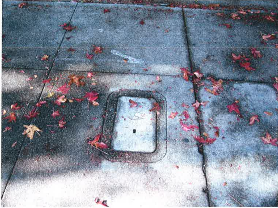
Vault V8 (Water)
