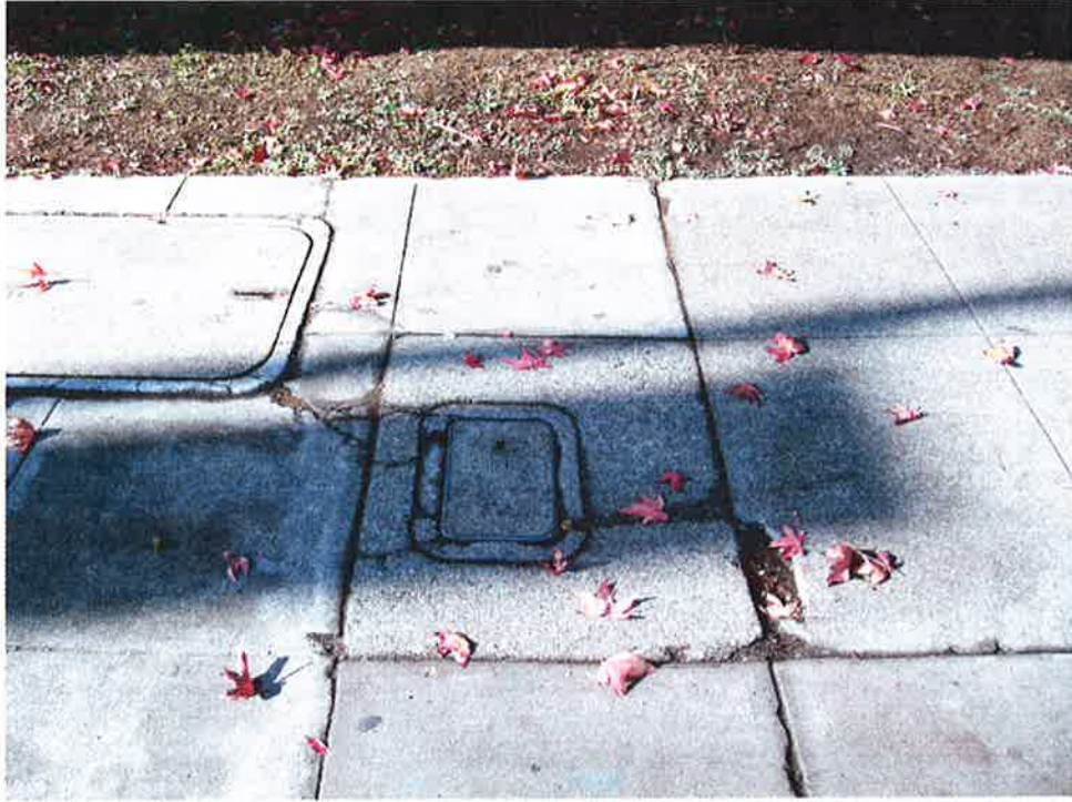
Vault V1 (Water)
