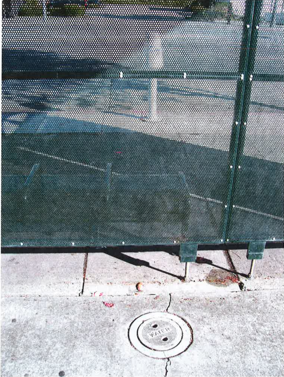
Vault V13 (Water)
